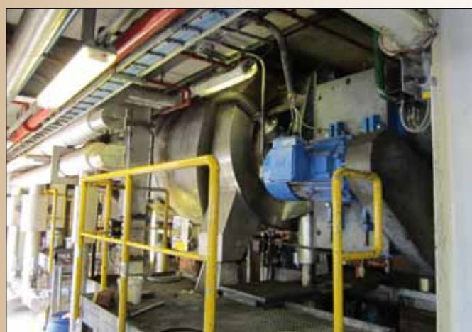
De drukreactor van de DFBN-plant van Chemtura. Blauw is de aandrijfmotor en tandwielkast voor de mengas. Op de achtergrond de horizontale buisvormige reactor.
